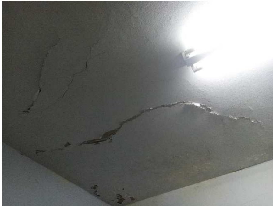
Estado de la estructura generado por filtraciones.
